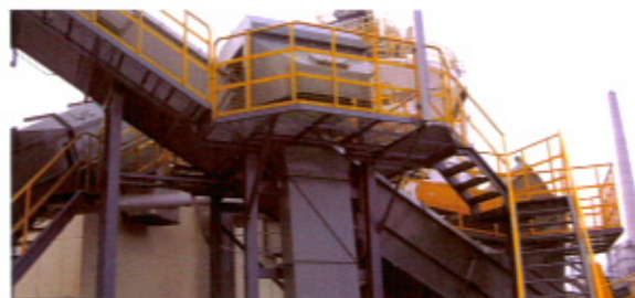
コンベヤライン磁選選別工程
