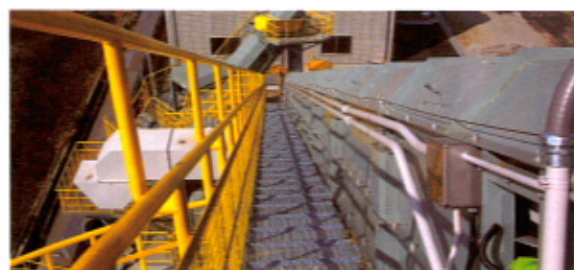
燃料サイロ投入コンベヤ
